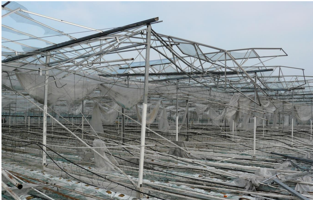
Przykład zniszczenia konstrukcji w wyniku tzw. katastrofy postępującej. Widoczna powyżej konstrukcja była przedmiotem ekspertyzy prowadzonej przez Koło Naukowe Konstrukcji Metalowych.
